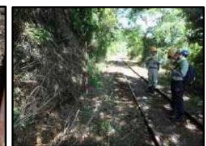
6k320m 落石(岩斜面崩落)
